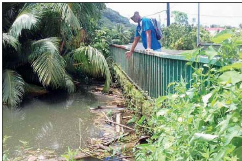
Des déchets végétaux commencent déjà à s'accumuler sous le tablier du pont qui enjambe la rivière Vaiaua.
