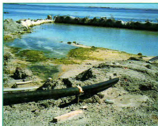
3 - Bassin de décantation
