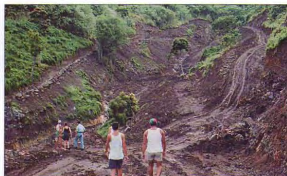
Terrassements pour la construction des routes : la technique de terrassement qui consiste à mettre en déblais le long de la route, au fur et à mesure de l'avancement des travaux est particulièrement nuisible.
