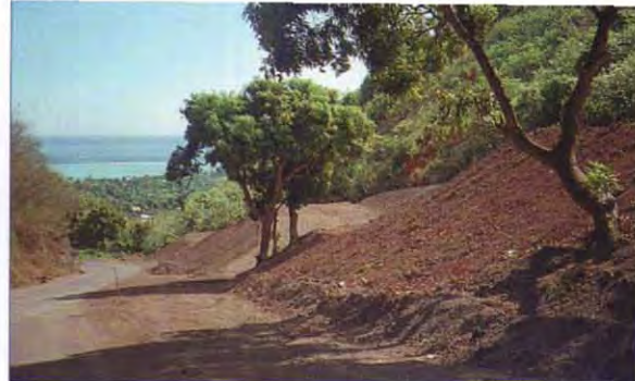
Terrassement pour la construction des lotissements : la multiplication des lotissements, construits sans aucune précaution, est principalement responsable. Le problème est surtout préoccupant à Tahiti, entre la Pointe Vénus et la vallée de l'Orofero.
